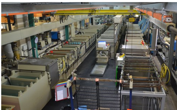
Ligne de galvanoplastie
